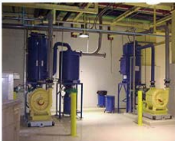
■ 廠房高壓清潔系統運用
